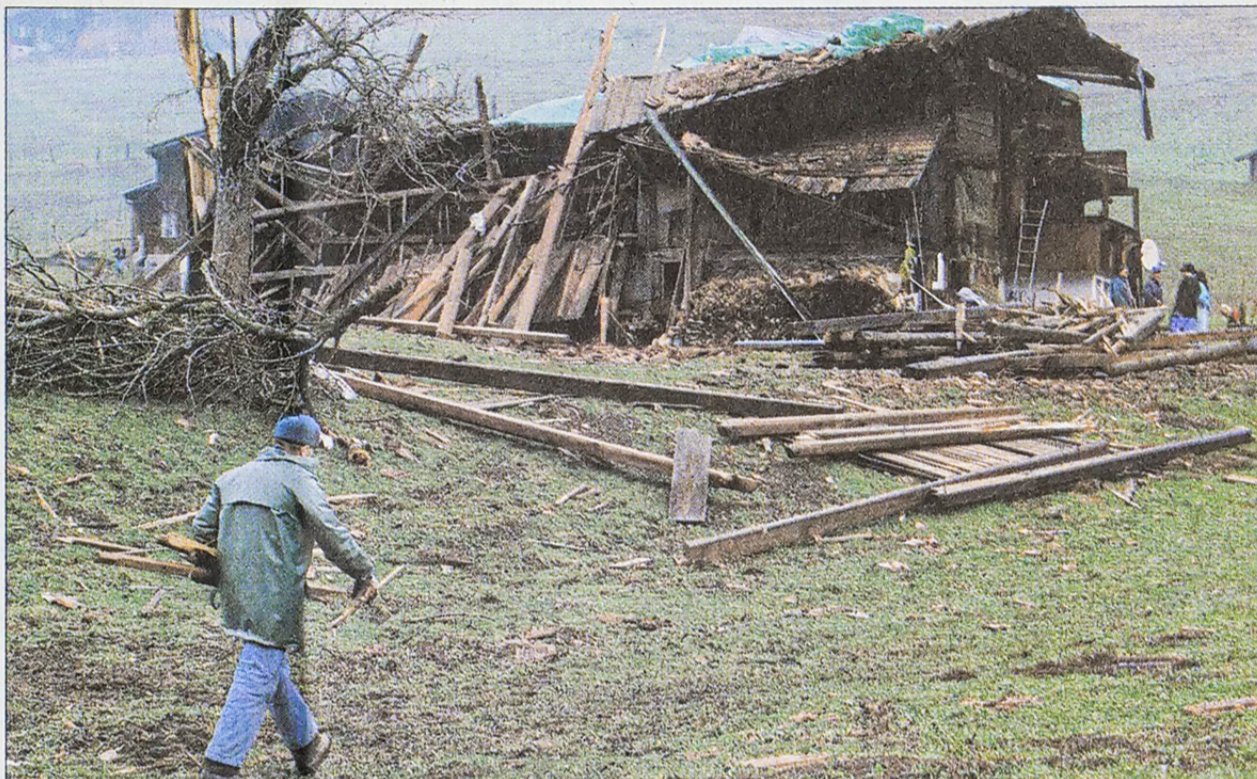
Auch an Gebäuden entstanden massive Sturmschäden. Unser Bild zeigt eine beschädigte Liegenschaft in Kandergrund im Berner Oberland. (Bild Keystone)
